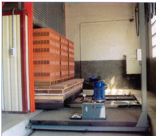
Al nuevo horno se le ha dotado de una serie de equipos que garantizan una mayor eficiencia en la cocción.
